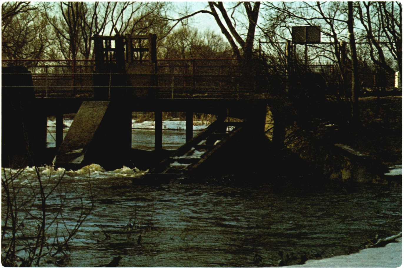
Danne og fisketrapp ved Ejeby Mølle mid i Odense by. Trappan byggdes 1976, som en av de første i projektet.
